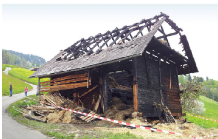
Die abgebrannte Scheune am Michelbühlweg in Sigriswil.
